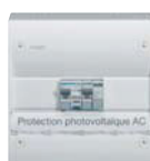
Coffret de protection photovoltaïque AC
